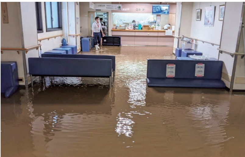
病院1階の浸水
